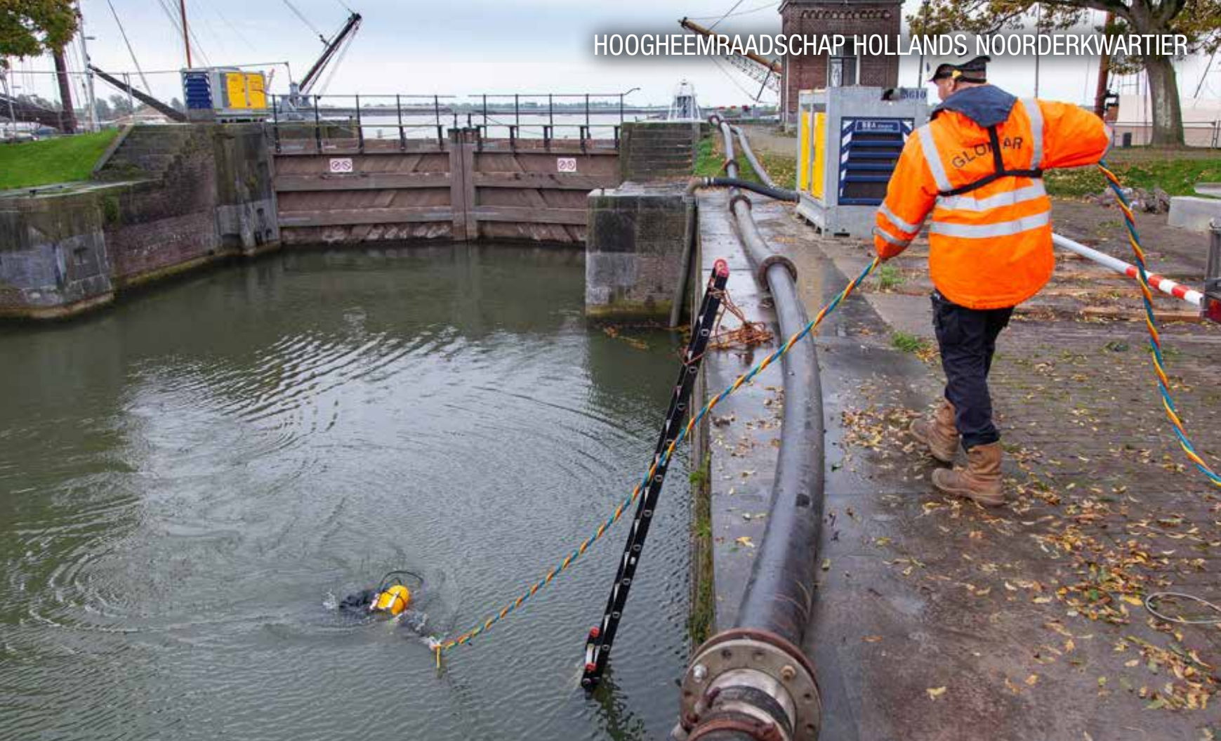
Een duiker inspecteert de Sasssluis in Enkhuizen ter voorbereiding op de versterking.
